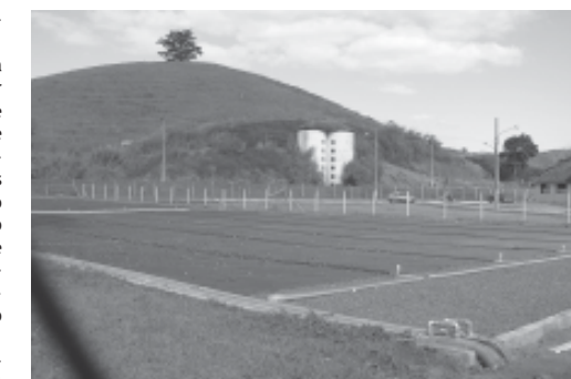
Painéis do aquecedor solar da piscina olímpica
