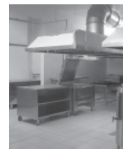
As instalações internas do novo restaurante têm padrão de alta tecnologia
